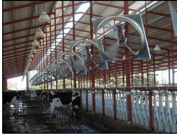
Resim 1.4: İyi bir havalandırma sistemi
